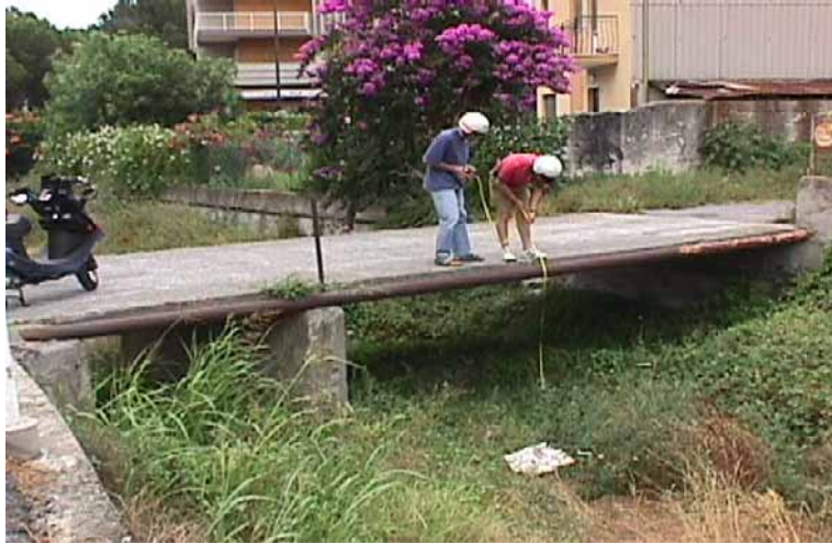
Foto 2.6.1.5: Torrente Bottassano: Ponte tra la Passerella pedonale e Via IV Novembre
