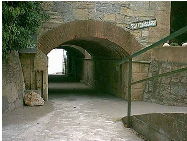
Figura 3.4.1.1.8- Sottopasso pedonale. Le acque del Rio provenienti dal tubo di raccolta defluiscono al di sotto dello stesso fino al mare.
