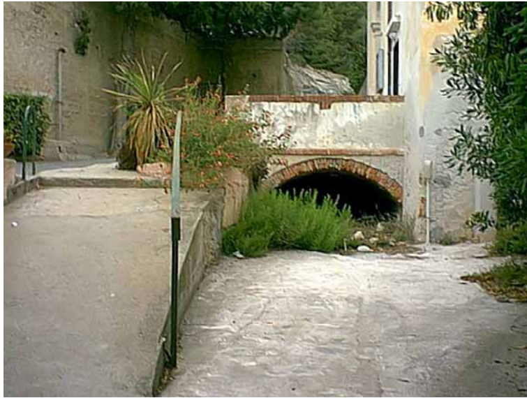
Figura 3.4.1.1.6 – Sbocco della copertura di accesso al cimitero. Le acque defluiscono sulla strada del sottopasso fino al mare.
